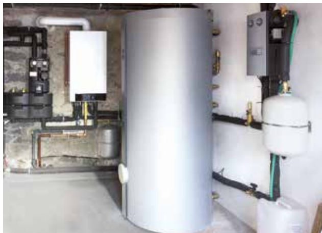
Couplée au système solaire combiné, la chaudière complète le chauffage de l'eau du ballon de stockage et optimise l'utilisation de l'énergie solaire.
